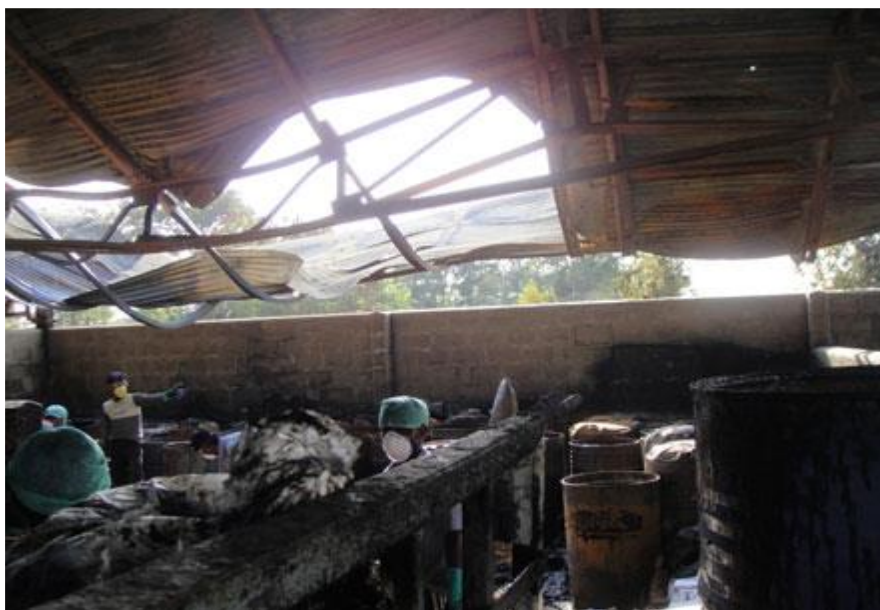
شکل ۱۳-۱۵ بنایی که در طول آتش سوزی به صورت جزئی آسیب دیده است.
